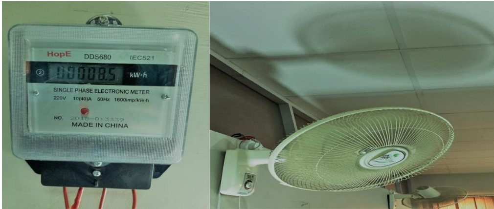
Fig 2. AC Bracket Fan and Energy Meter
